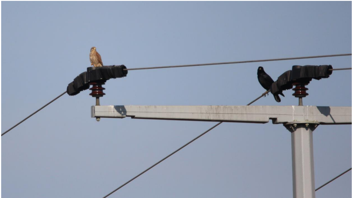
Abb. 47: Gegen Stromschlag ist die Mehrzahl der Freileiter mittlerweile isoliert.
