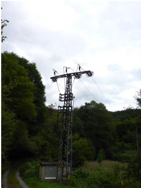
Abb. 50: Gesicherter Mast, jedoch ohne Sicherung der Seilabspannung über die Bachaue (Gammelsbach)
